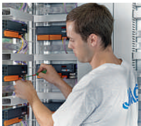
Montage von Steuerschränken für die Automation von Prozessanlagen
